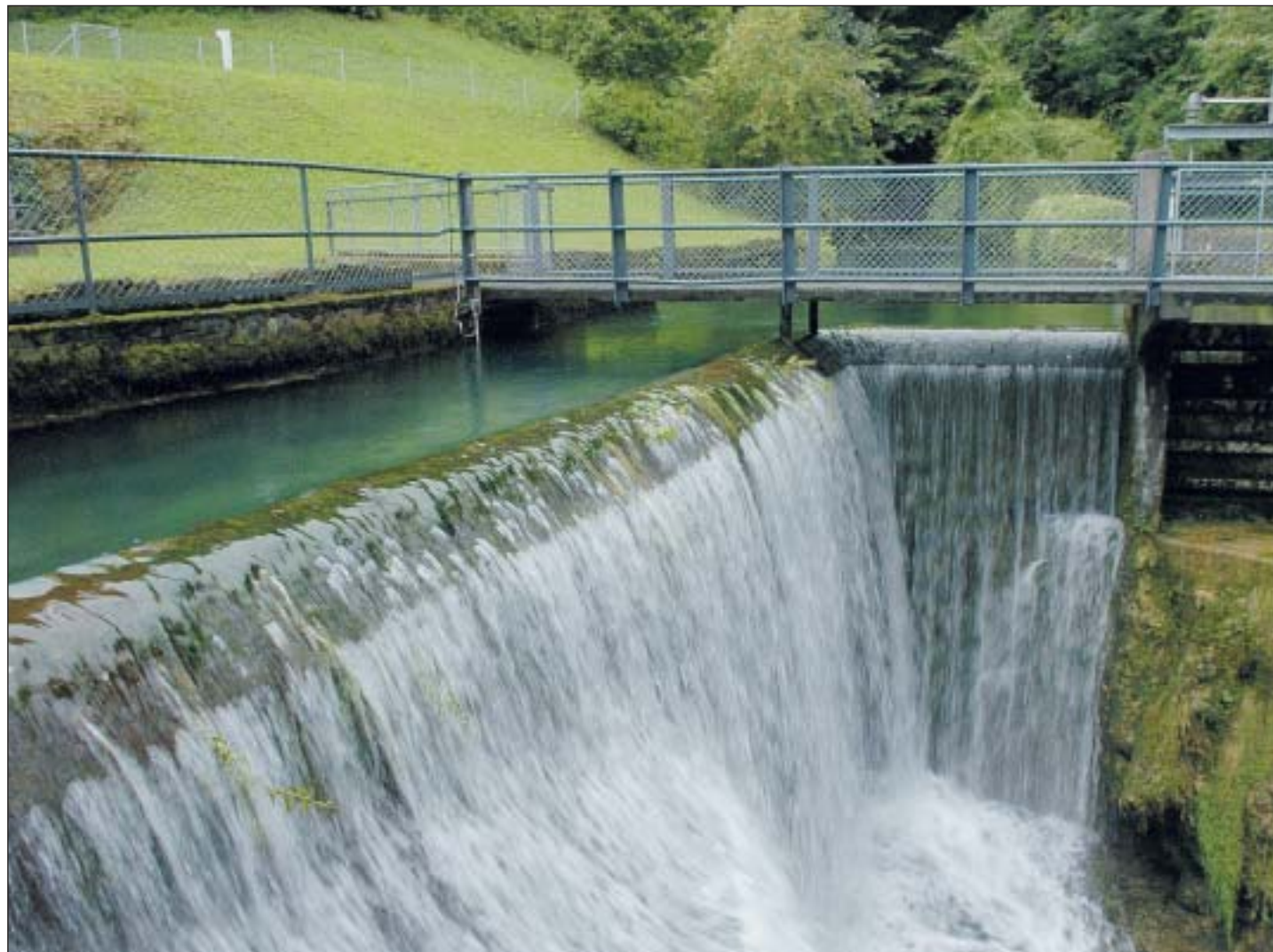
La rénovation, pour un montant de 3,5 millions de francs, des installations de turbinage de l'eau de la Serrière va faciliter la production d'une quantité considérable d'électricité.
